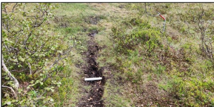
Figur 5.64: Nærbilete av lokalitet 10. der ein kan sjå dei fine massane det er avlese djupne- og breidde-målingar i. Bilete er teke under første feltundersøking med meterstokk på om lag 21 cm.
