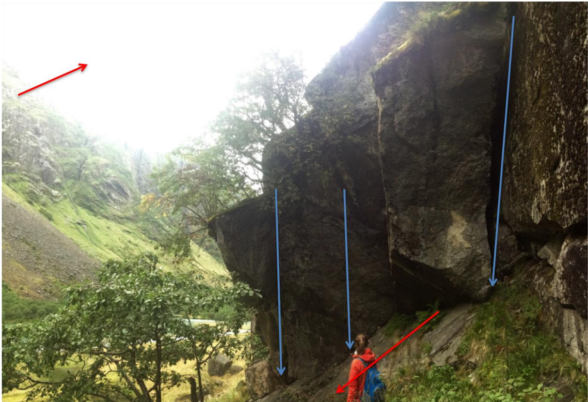
Figur 4.27.5: Den røde pilen ligger langs glideplanet. Blå farge viser tydelige og vel utviklede, nært vertikale sprekker
