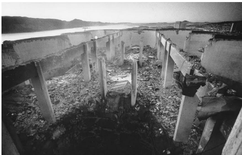
Figur 6: Illustrerer ødeleggelser av tak på silo i Stavanger i 1985, Eckhoff [1].
