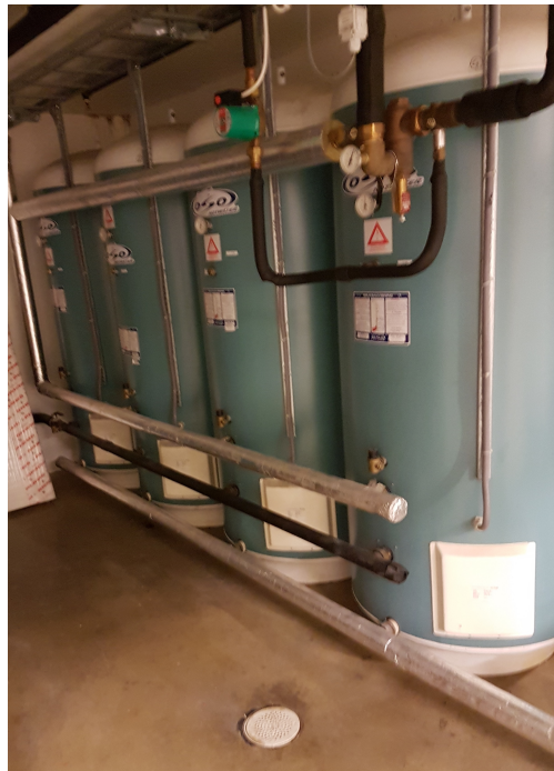
Figur 3.5: Illustrasjon av et oppsett med akkumulatortanker. Dette systemet er fra Komplett Arena.
