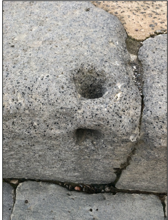
Figur 8: Hull i fortauskant (Forfatter)
