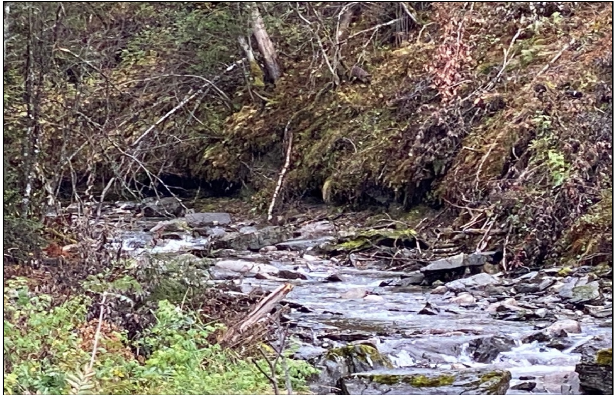
Figur 13: Erosjonszone i nedre del av Langegjolo. Skråningen ned til vassdraget er svært ustabil og tilgang på minerogent materiale er god. Tilsvarende erosjonszoner finnes flere steder i Langegjolo og Sundsvåselvi.
