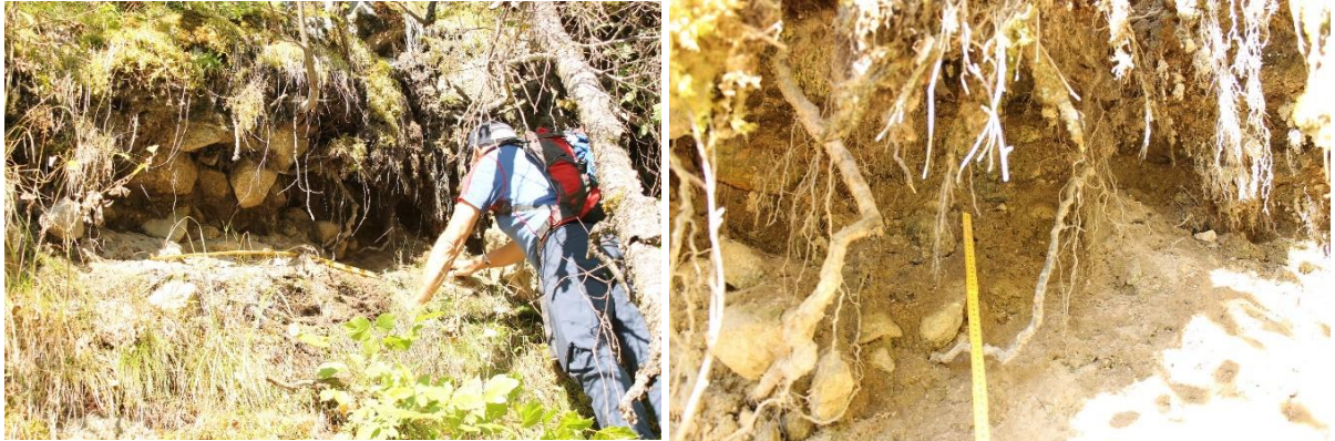
Figur 5.9.7a og b Blotning i bekkeløpet på vifte 9-1 med mye finmateriale under et lag av kantrundede blokker med en diameter på ca. 20-50 cm.
