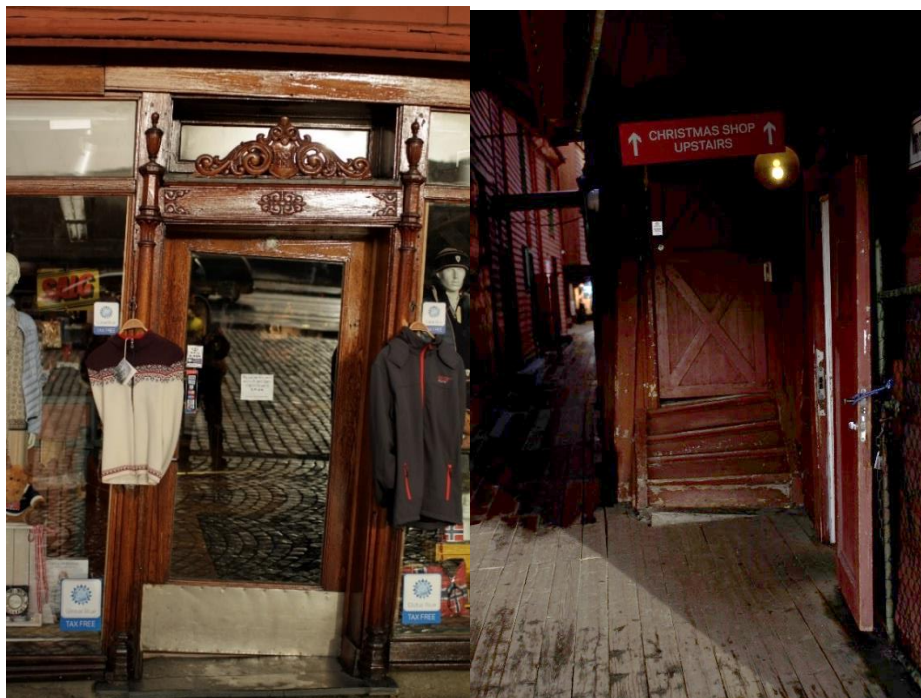
Figur 3-11: To bilder tatt på Bryggen for å illustrere hvordan setning har ført til skjevheter i bygningene (Foto: Joakim Haukedal)
