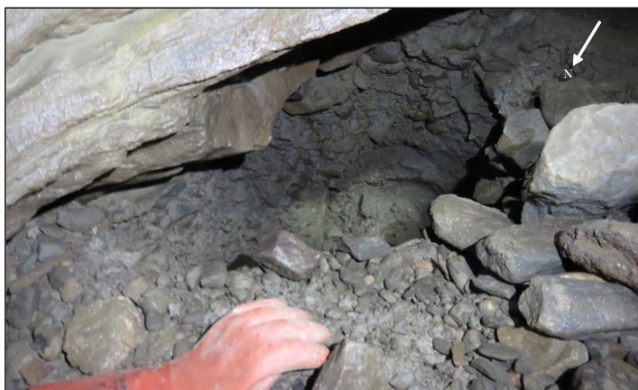
Figur 50 1 meter dyp grop hvor løsmasser har sunket ned i underliggende hulrom. Kamera ser inn mot sør-øst. Foto: Ida Marie Gabrielsen
