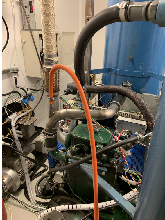
Figur A5: Petter diesel med tilkoblet propan (orange slange) og avgass til gasstørker (til høyre)
