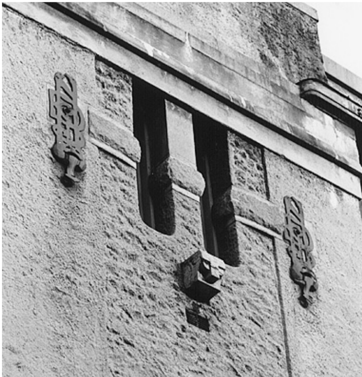
017. Ornamentikk på de fremspringende partiene på scenehusets sidefasader. Differensiert materialbruk, dyremaske og murankre i form av DNS' initialer.
