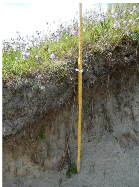
Figur 5.22: Erosjonsskrent i overvåkningspunkt 4.
