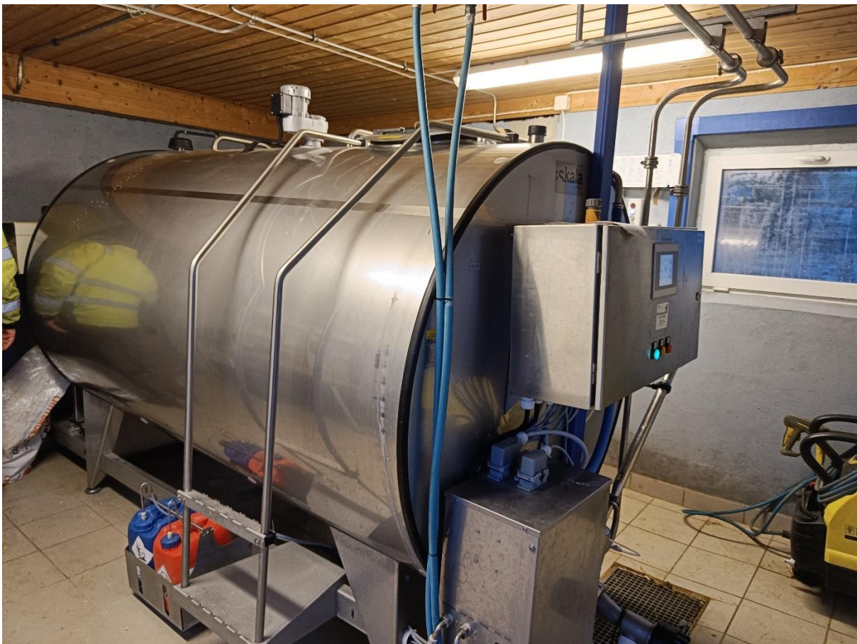
Bilde 7: Melketank montert i ett rom som bare eksisterer fordi roboten skulle inn i driftsbygningen. Kilde: Meg selv.
