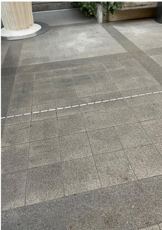
Bilde 53: Spor etter lekkasjen
