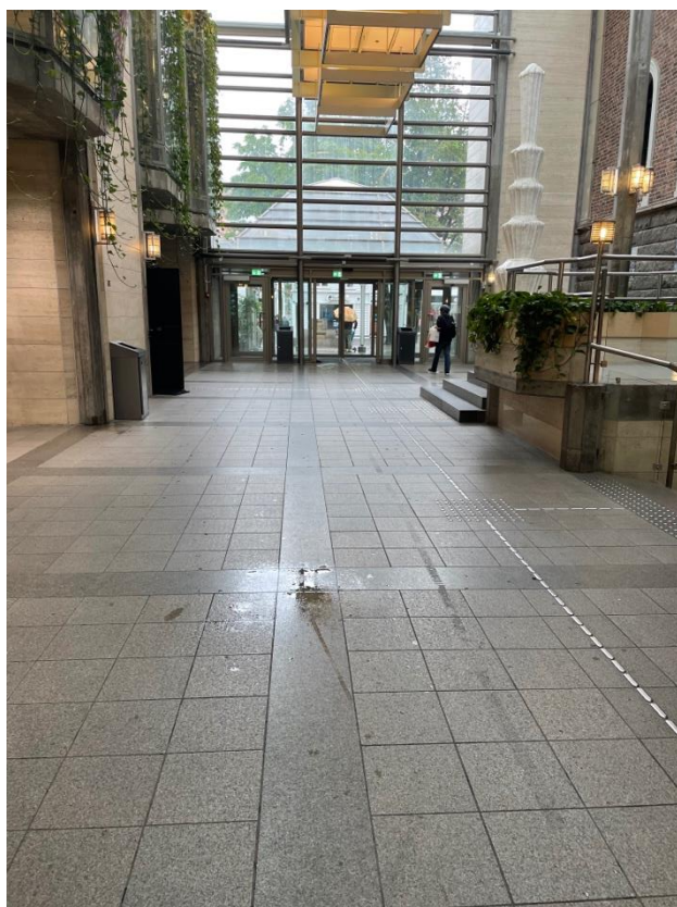
Bilde 44: Passasjen mellom de to inngangsdørene. Vått gulv etter taklekkasje
