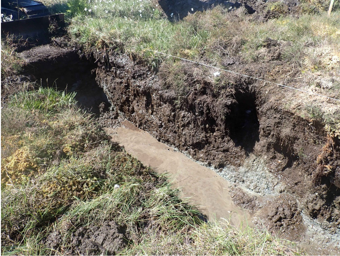
Figur 7 Åpning av sjakt på Lokalitet 1 med et kort glimt av profilet før innstrømming av vann. Sett mot SV.
