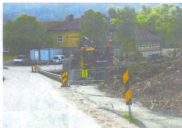
TOK TID: Kloakkanlegget ved Øvrebygda skule har vore dårleg i fleire tiår. Først no blir det ordna opp i. FOTO: STEINAR HYSTAD
