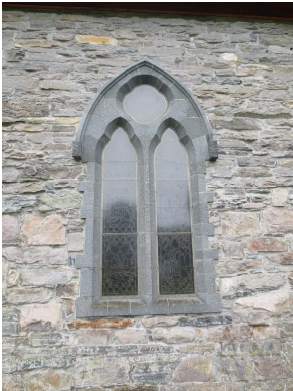
Fig. 4.4. Grindeverksvindu i korets nordmur. (Foto: Marius Fugelsnes 13.02.2015)
