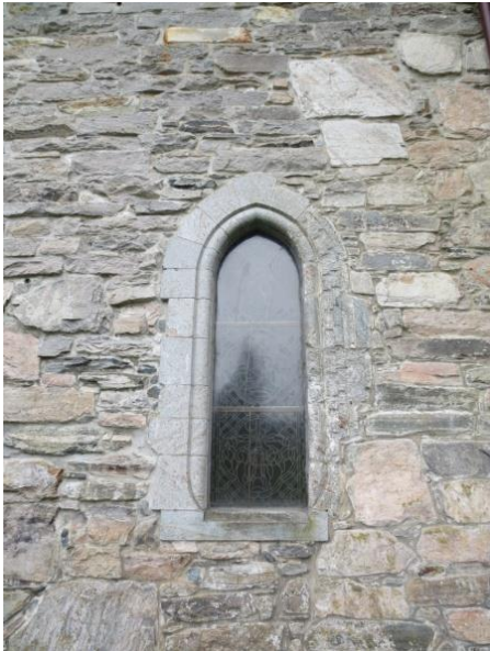
Fig. 4.5. Gotisk vindu vest for grindeverksvinduet. Steinen til venstre ser ut til å være ny og i bedre forfatning enn steinen til høyre, som tyder på at deler av vinduet har vært ødelagt før restaurering. (Foto: Marius Fugelsnes 13.02.2015)
