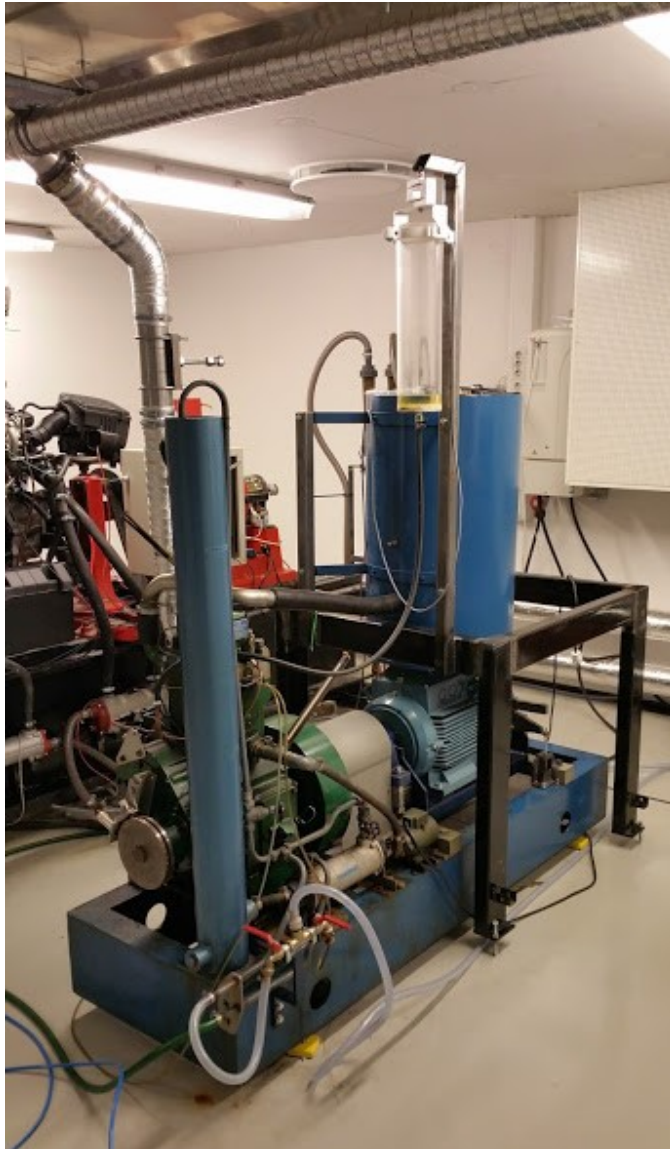
FIGUR 2.10: Bilde av Petter Diesel PH1W i maskinrommet. Eksosrøret fra motoren er koblet til rommets eksossystem i taket.
