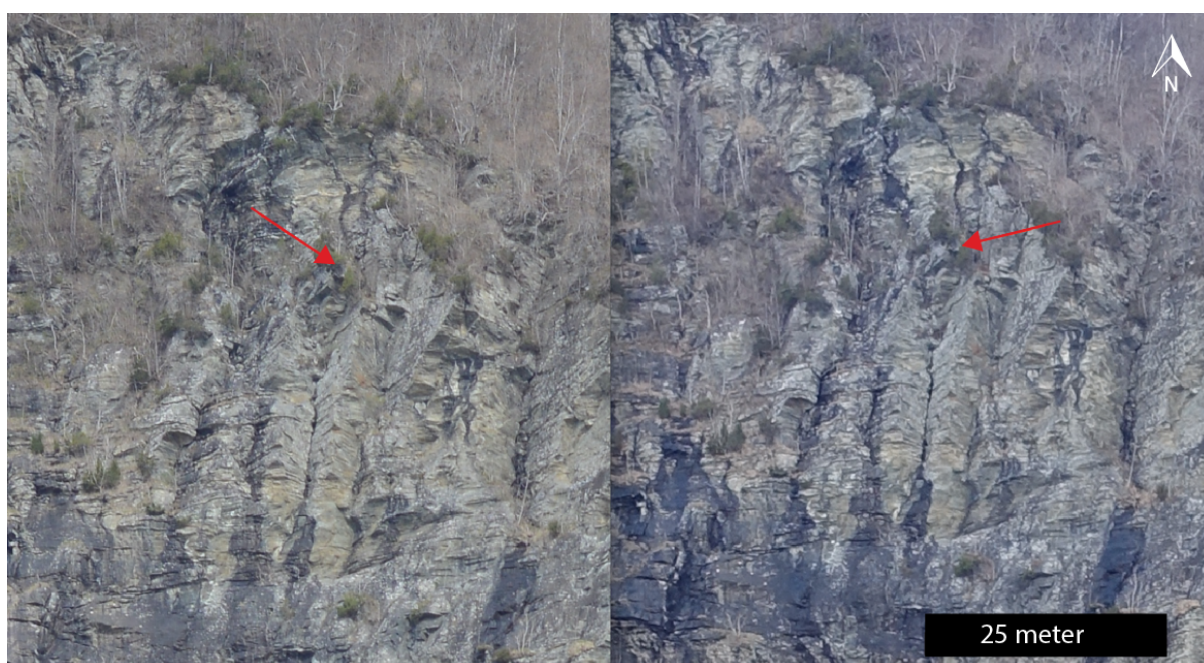
Figur 35: Fra lokalitet 1c. Bildet til høyre er fra april 2015, mens bildet til venstre er fra mars 2016. De røde pilene indikerer posisjonen til endringen i utsnitt oppe til venstre i Figur 34. Foto: Ragnhild L. Norang.
