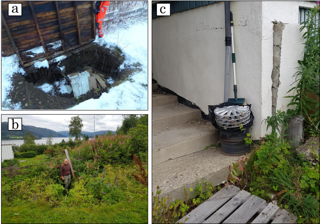
Figur 3.10 a) Jordfallshull på Tuvsetta i 2013. Beboerne har fylt igjen hullet med treverk. Foto: Lauritzen (2013) b) Jordfallshull på Tuvsetta i 2018. Treverket er fjernet og tett vegetasjon preger dolinen. Foto: forfatter c) Setningsskader på hus, 2018. Deler av grunnveggen har falt ut og hageoverflaten ved trappen har sunket betraktelig. Foto: forfatter.
