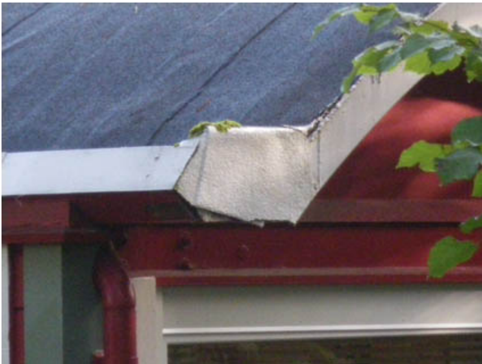
Fig. 66. Avkappet bjelke/takrenne med et noe nødtørftig ”beslag” utenpå.
