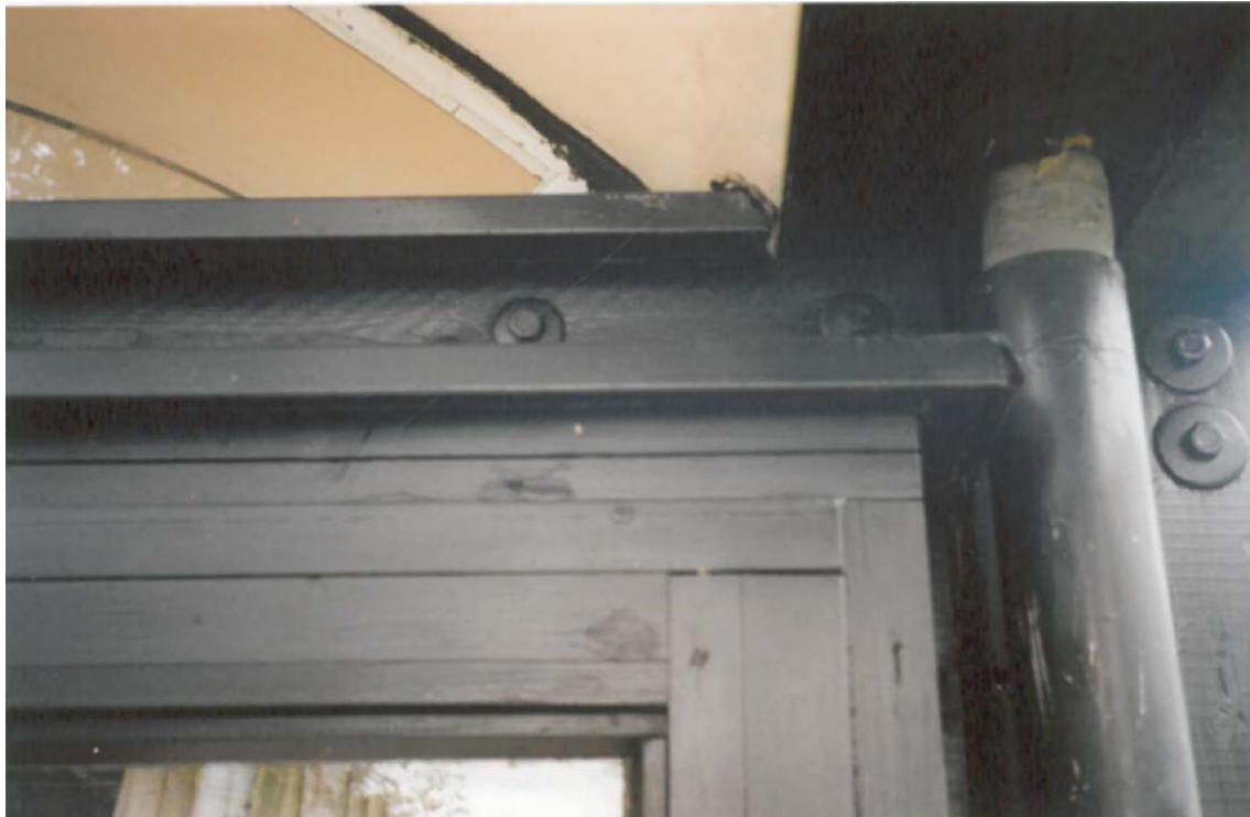
Fig. 27. Forsøk på å tette lekkasjer i taket på familien Willes sommerhus på Tjøme.
