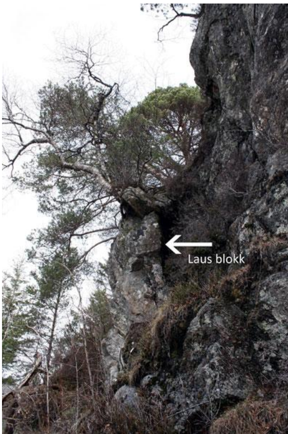
Figur 58. Blokk med open sprekk bak.
