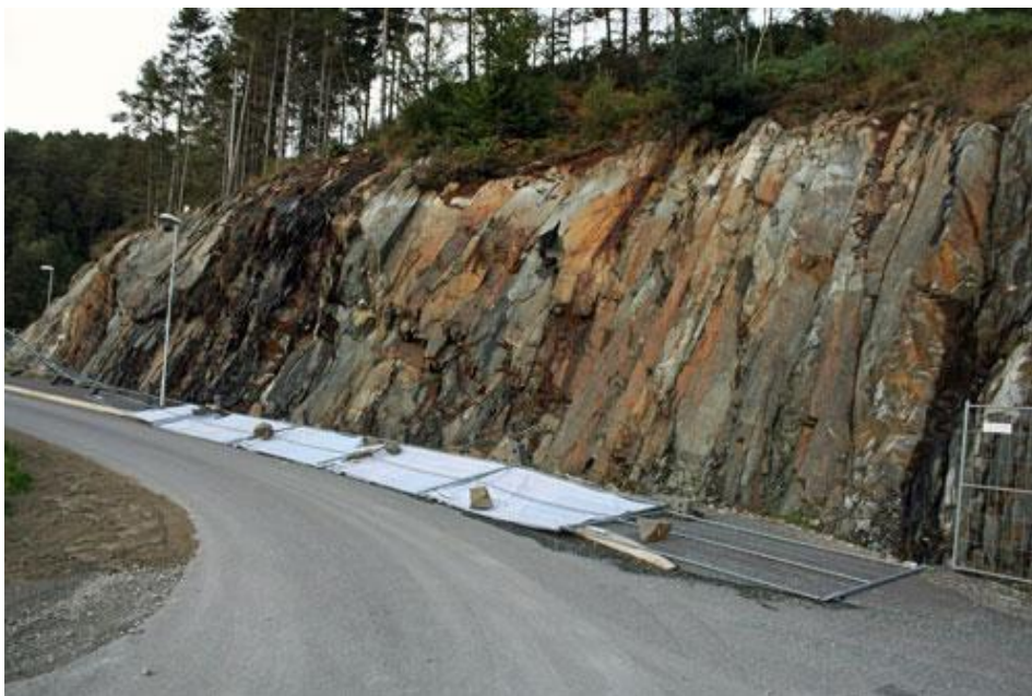
Figur 30. Steinsprang 17.09.10 i nedre delar av byggefeltet førte til at sikringsgjerdet som skulle verne mot steinsprang vart velta.
