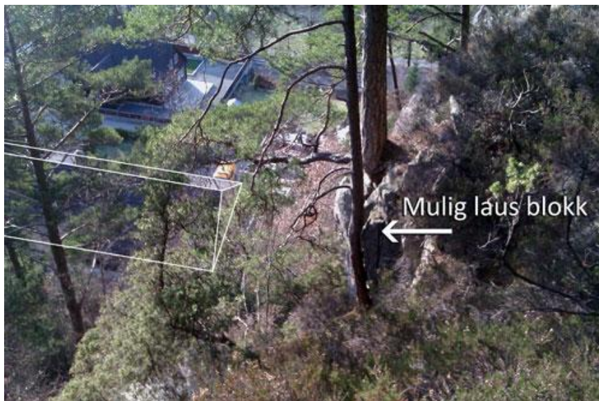
Figur 26. I øvre delar av fjellskrenten er det observert fleire furutre som veks i sprekker langs kanten. Bildet viser ei blokk med opne sprekker rundt og med fururot som veks i bakre sprekken. Omriset til taket til firemannsbustaden nedanfor er teikna inn for å tydeleggjere huset.
