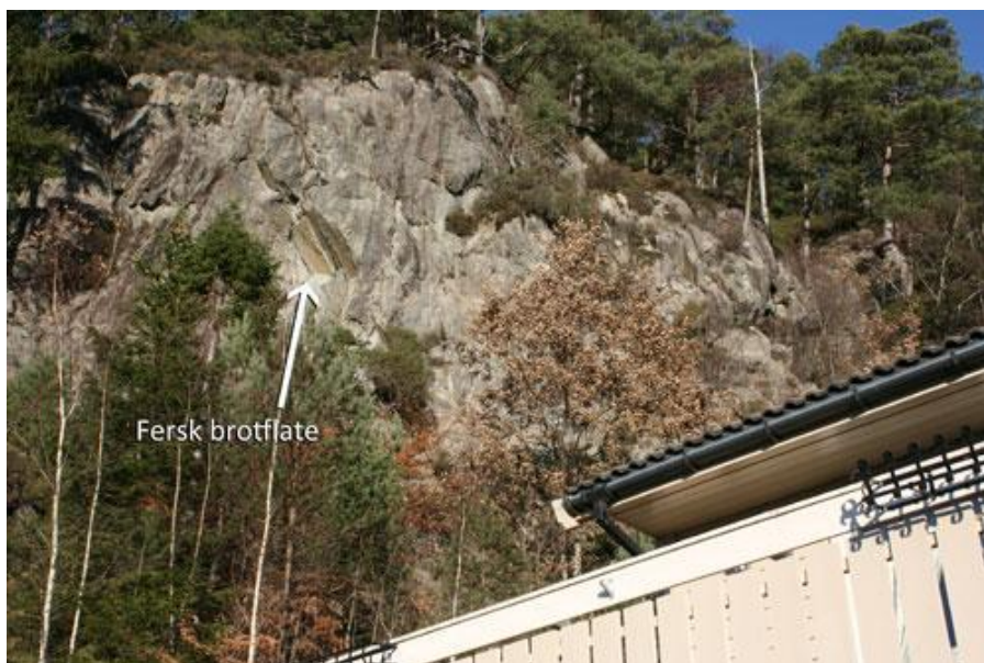
Figur 24. Den nær vertikale fjellskrenten har fleire sprekkflater som dannar overhenga. Eit av desse overhenga har ei forholdsvis fersk brotflate. Furskogen i overkant av fjellskrenten veks i sprekkene langs kanten.
